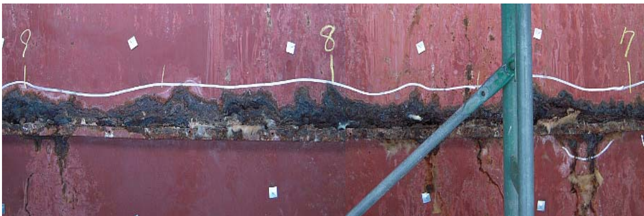
タンク側板外面腐食状況写真
